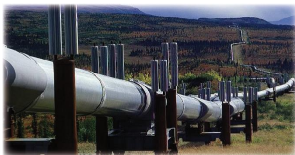
ท่อขนส่งน้ำมันดิบจากแหล่งผลิตบริเวณเมืองพรูโดเบย์ ทางภาคเหนือมายังโรงกลั่นที่เมืองเวลดี ทางภาคใต้ของรัฐอะแลสกา ประเทศสหรัฐอเมริกา
